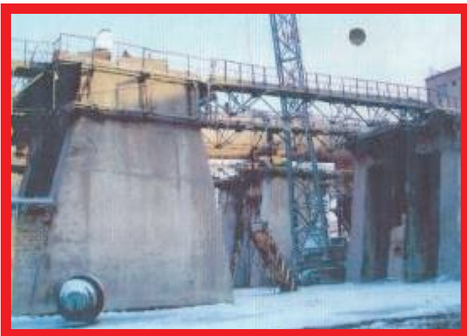
Halálos baleset a vállalatcsoportnál - Esettanulmány, 2005: Vállalkozó leesett a járófelületről, amelyet éppen emeltek.
