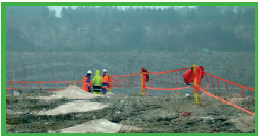
System bariér na lomovej stene.
