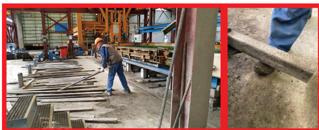
Nehoda z októbra 2018: Pri odstraňovaní blokovacích tyčí (kovových lamiel) z otočnej stanice pracovník, ktorý mal na nohách bezpečnostnú obuv bez ochrany strednej časti chodidla, upustil jednu z lamiel na nohu za špičku topánky, čo malo za následok zlomeninu strednej časti chodidla.
