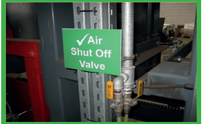
Jasne identifikovaný bod odpojenia a zaistenia pneumatickej energie.
